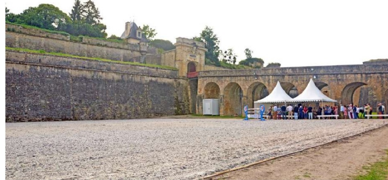
Pose de géotextile, drain d'évacuation de l'eau, couches de calcaire et de sable fibré pour la souplesse : rien n'a été laissé au hasard pour ce paddock flambant neuf, d'une superficie de 1400 m2.
